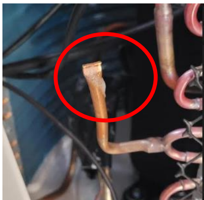
Tubo de serviço
