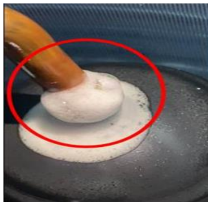
Tubo de sucção do compressor
