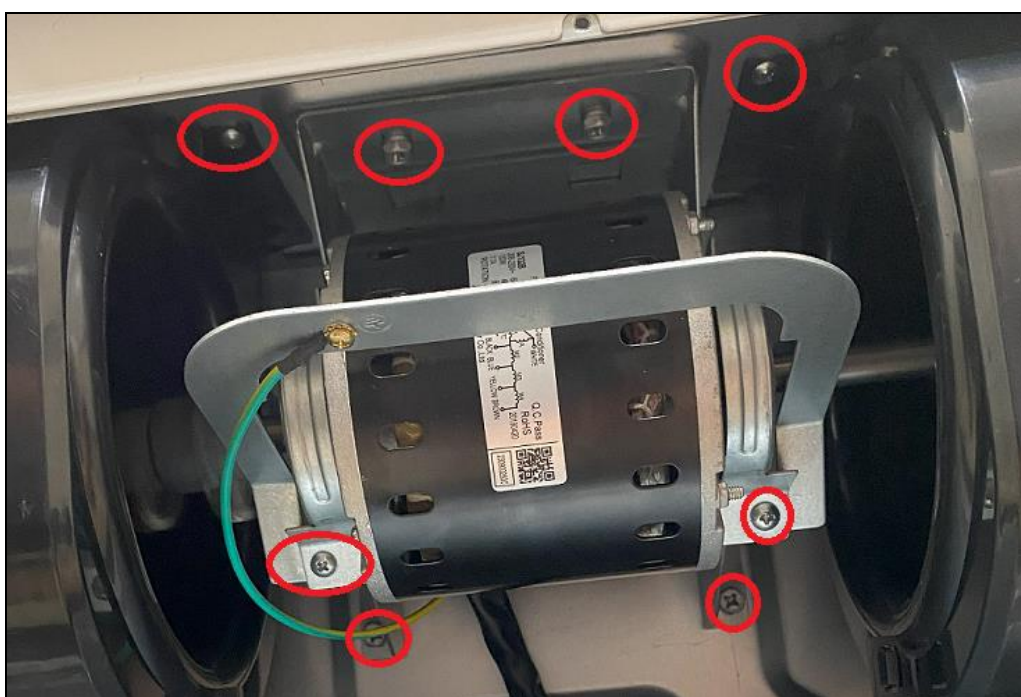
Imagem 01 – Parafusos de fixação do motor de ventilação.
