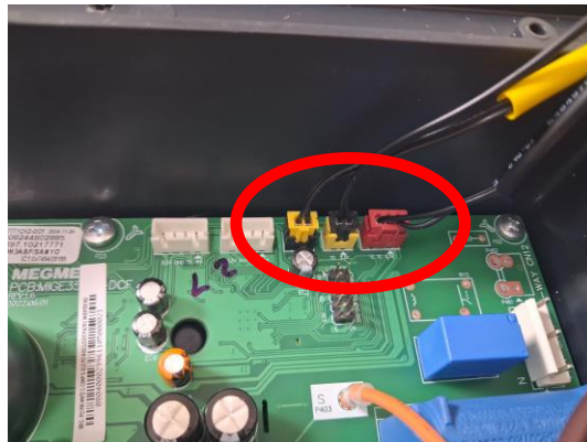
Imagem 2 – Inversão dos conectores.
